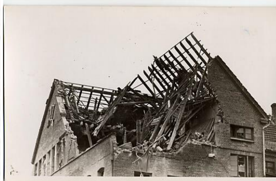
Blick auf die Westseite des von zwei Fliegerbomben getroffenen Pflegehauses Horeb.
